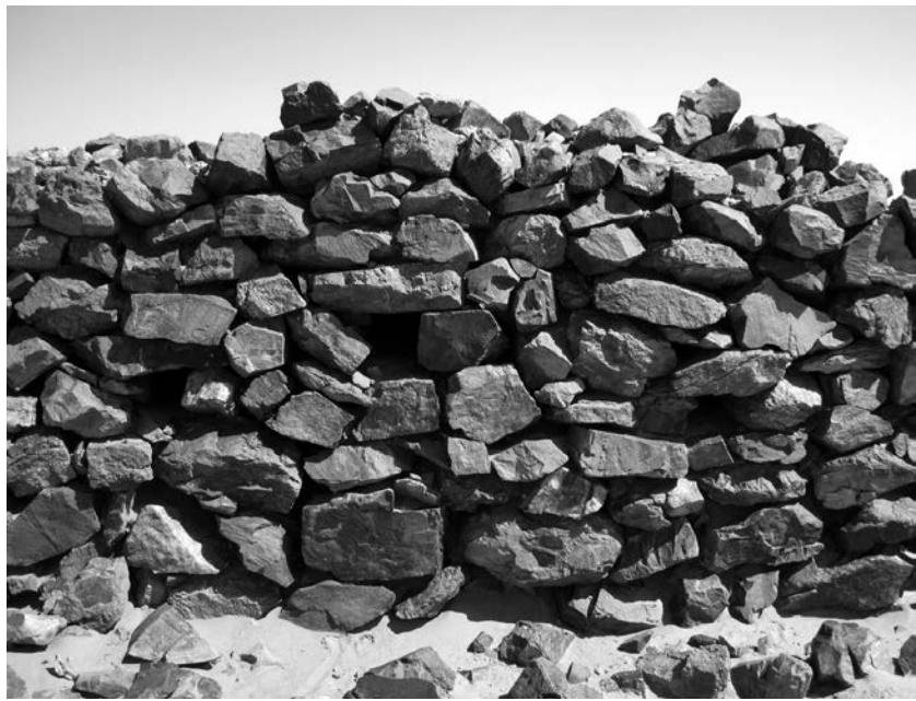
Abb. 9: Die Ruine Quweib, Ansicht der westlichen Aussenwand von Raum 11 (Ausschnitt). In regelmässiger Abfolge wechselt die Höhenlage der Fenster. (Foto: D. Eigner).
