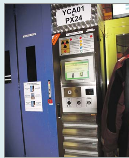
Viel Technik und Sicherheitsvorkehrungen schon am Eingang zur Schleuse Fotos: ch
