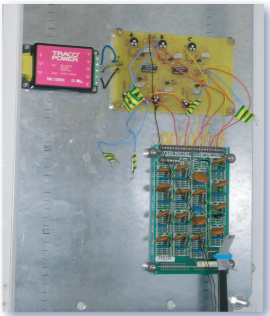
Abbildung 6.6: Foto des Sensorik-Schaltschranks. Links im Bild das Netzteil (pink), das die Temperatursensoren (gelb) mit Spannung versorgt. Das Anschlussboard (grün) ermöglicht eine einfache Verbindung der Signale mit dem Rechner.
